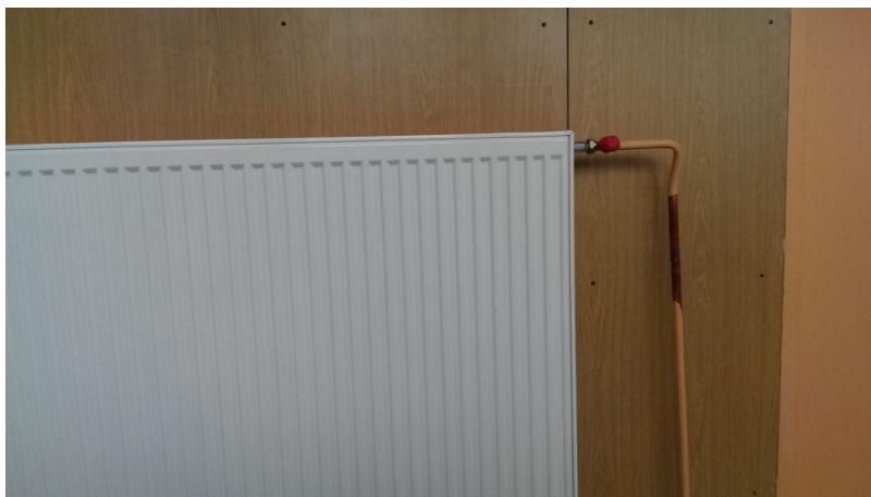
Slika 12: Radiatorji z navadnimi ventili
