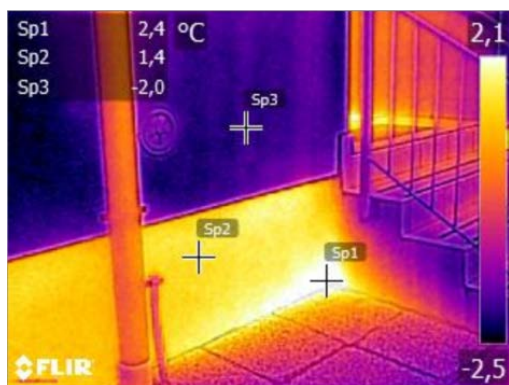
Slika 18: Termografski posnetek slabe izolacije.
