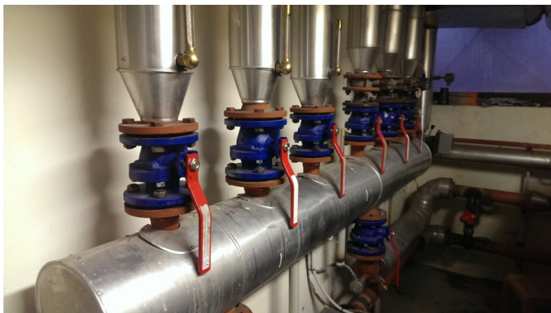
Slika 8 Kotlovnica- delilne veje
