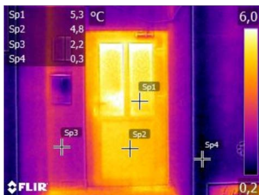
Slika 17: Termografska slika iztrošenega stavbnega pohištva.
