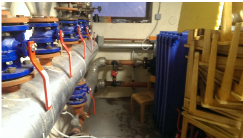
Slika 11. Kotlovnica v stavbi- delilne veje toplote
