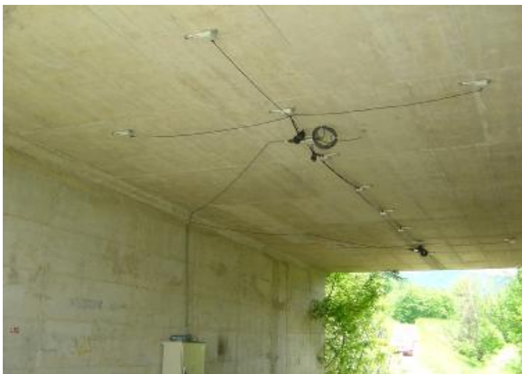
Slika 28: Način namestitve sistema SiWIM-a na most (vir: SiWIM Bridge Weigh-in-Motion Manual. 2005, str.70).
