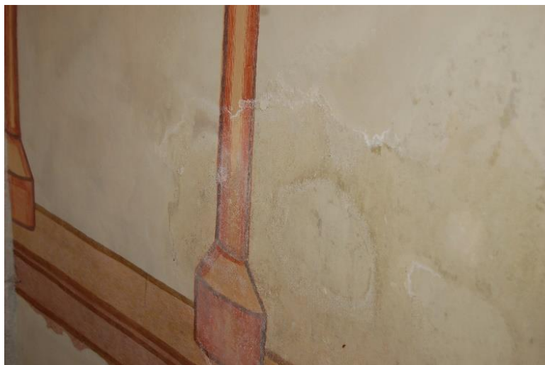
Slika 1: Izločanje soli na površini stenske poslikave po injektiranju zidov s cementno injekcijsko maso
