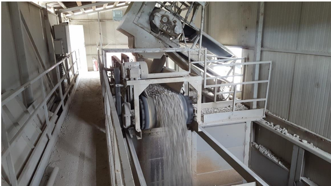
Slika 18: Premikajoči transportni trak na vrhu silosa polni določen silos z izbrano frakcijo agregata [16]
