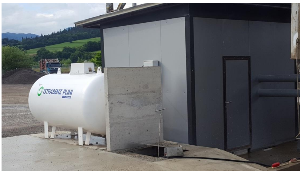
Slika 12: Plinski rezervoar za gretje vode v zimskem času ter kotlovnica [16]
