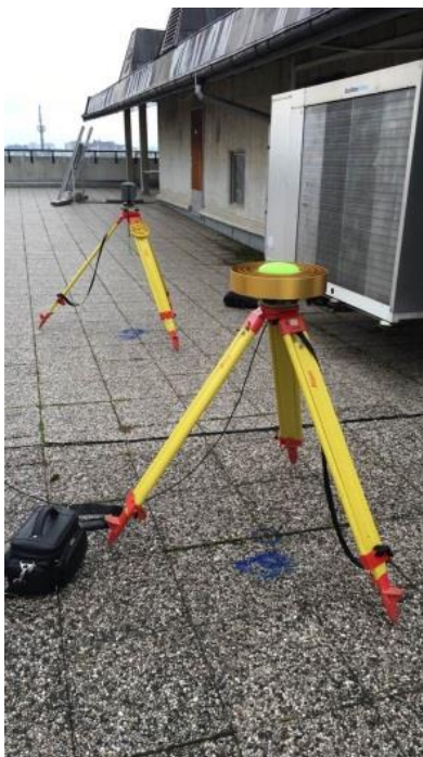
Slika 16: Prikaz delovišča na strehi Fakultete za gradbeništvo in geodezijo: točki A in B
