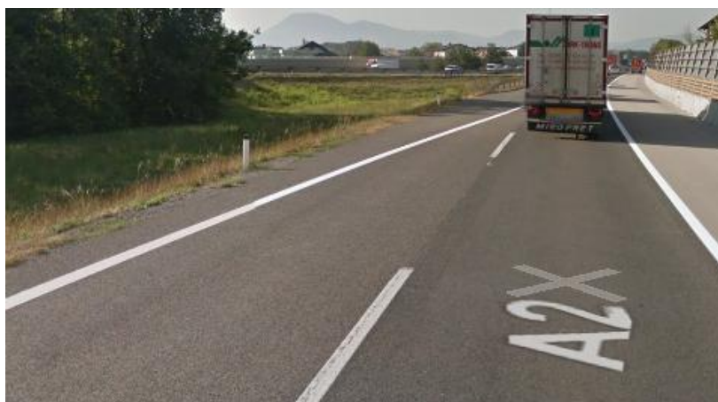
Slika 28: Neprimerna ureditev prečnega profila rampe na VNV Kozarje (Vir: https://www.google.si/maps/ )
