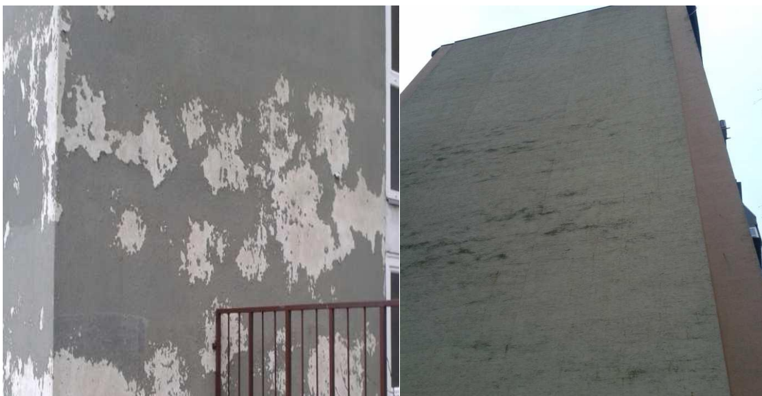
Slika 5: Poškodovana fasadna barva
