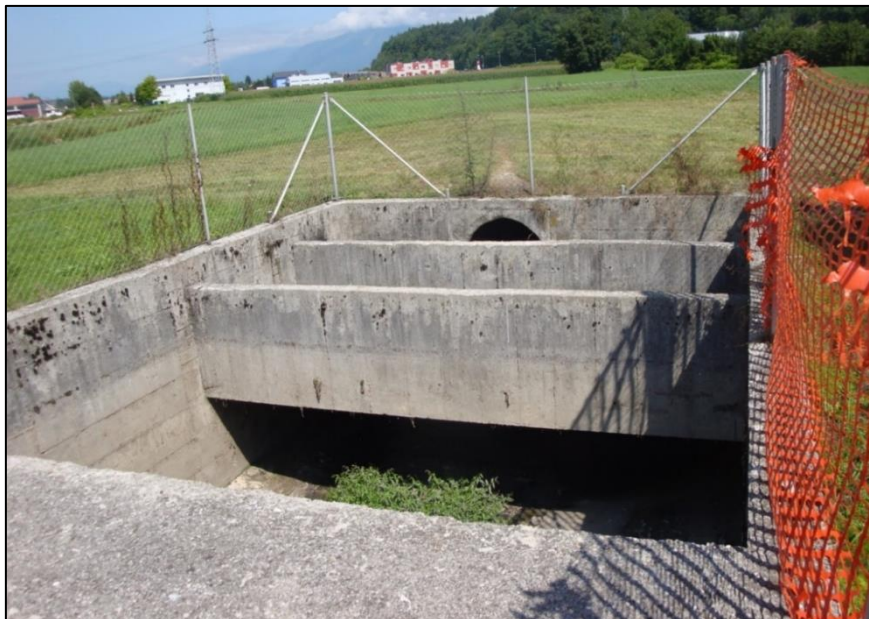
Slika 11: Zadrževalni bazen ZB 7 (osebni arhiv). Figure 11: Stormwater tank ZB 7 (personal archive).
