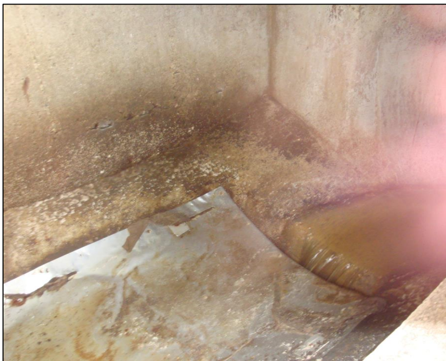
Slika 12: Razbremenilnik z delilno ploščo – RA 23 (osebni arhiv). Figure 12: Stormwater overflow with separator plate – RA 23 (personal archive).
