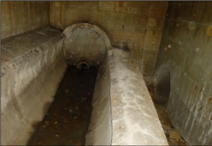
Slika 10: Razbremenilni objekt na ZB 11 (osebni arhiv). Figure 10: Stormwater overflow – ZB 11 (personal archive).
