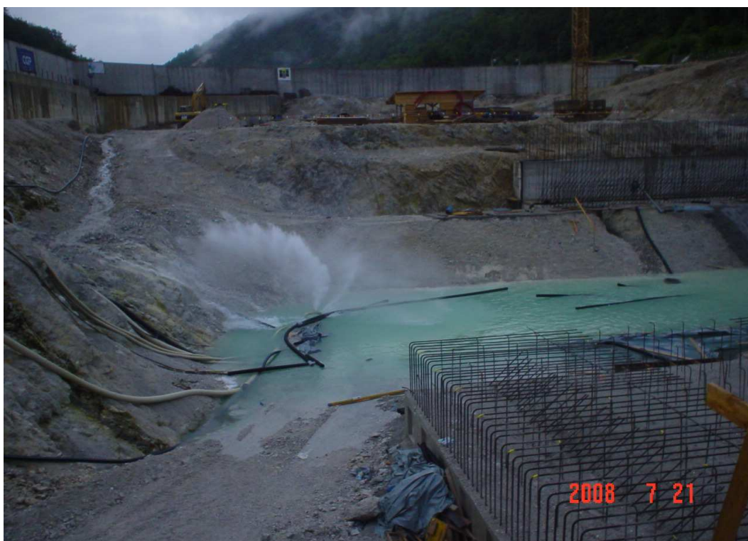
SLIKA 32: Poplavljena gradbena jama zaradi počene cevi črpalnega sistema
