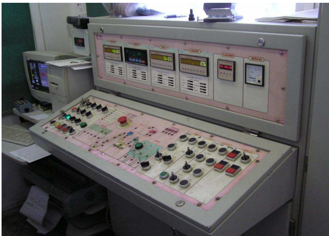
SLIKA 20: Krmilni sistem betonarne
