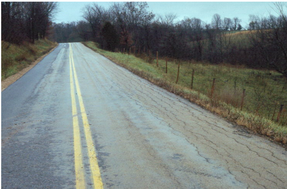
Slika 6: Razpoke zaradi posedanja
