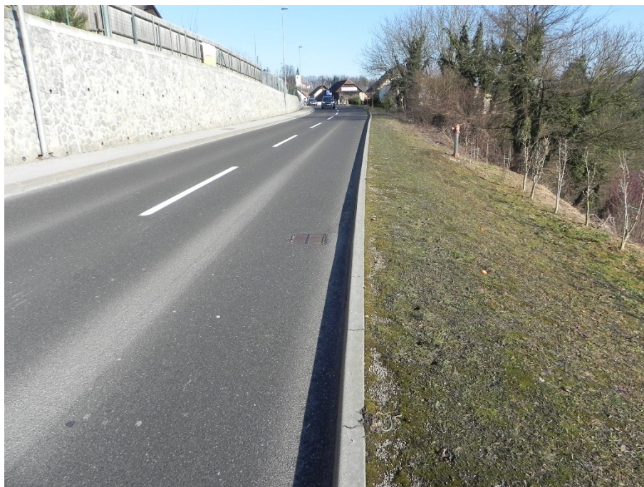
Slika 20: Vtočna rešetka, zgrajena v liniji kolesnice in nevarnost zleta s ceste
