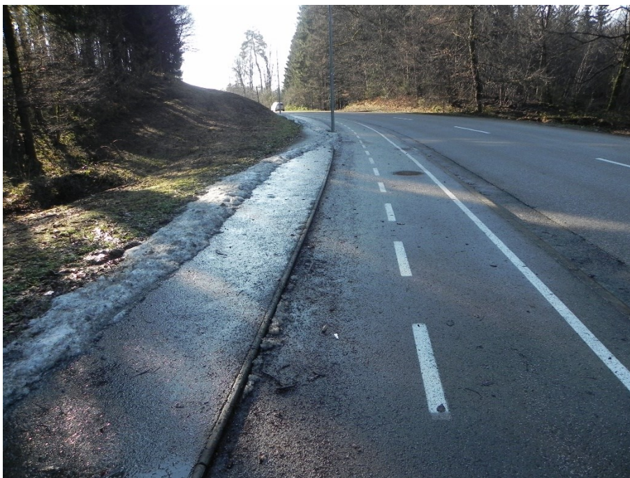
Slika 43: Neustrezna višinska izgradnja kolesarske steze in hodnika za pešce ter neustrezna postavitev javne razsvetljave ob lokalni cesti LC 295052
