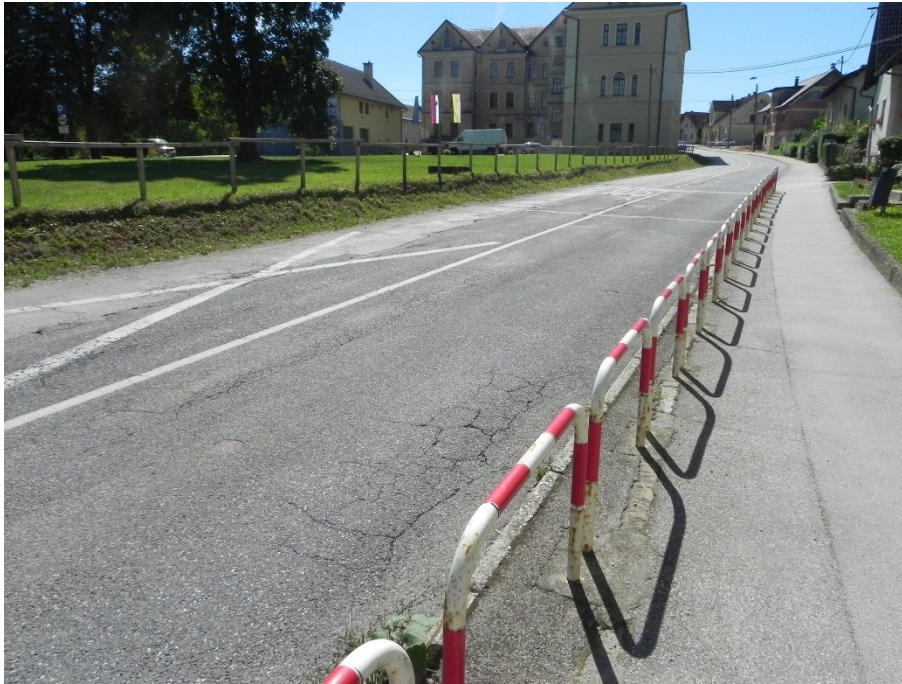
Slika 38: Mrežne razpoke in posedki na vozišču Šmihelske ceste
