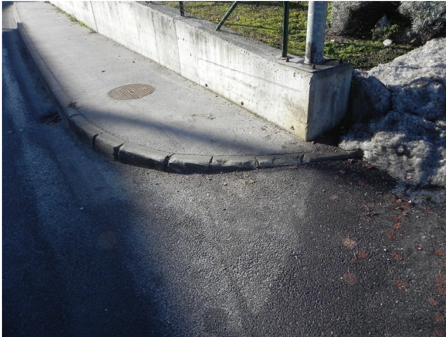
Slika 22: Nepravilno izvedeni poglobljeni robniki pri piceriji Mačkovec
