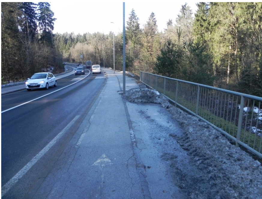
Slika 34: Vidne razpoke na Andrijaničevi cesti in neprimerna postavitev javne razsvetljave
