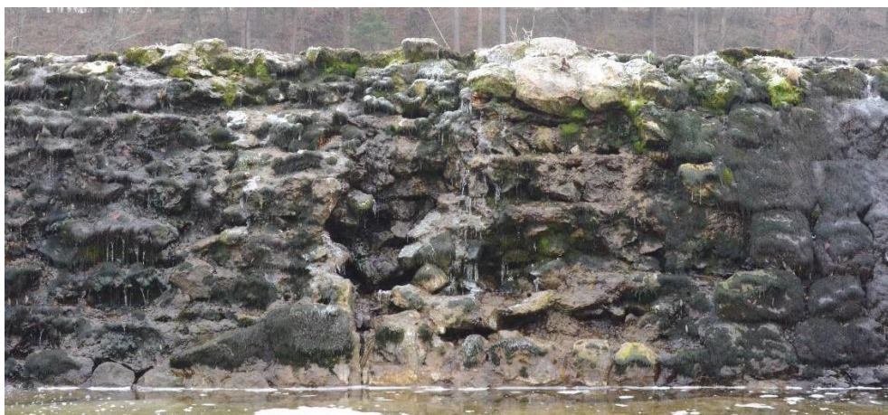
Slika 9: Poškodbe v telesu jezua (manjkajoči kamni v kamniti oblogi jezua in mestoma erodiran nearmiran beton).
