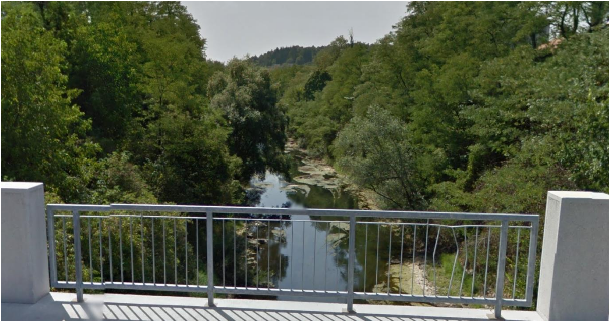
Slika 9: Zaraslost brežin Gruberjevega prekopa na Cesti Hrdeckega ( www.google.com/maps )
