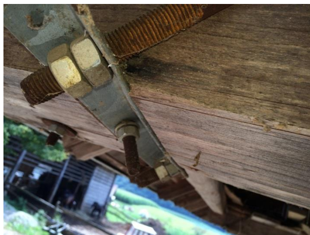
Slika 5: Deformiranje jeklenega kotnika
