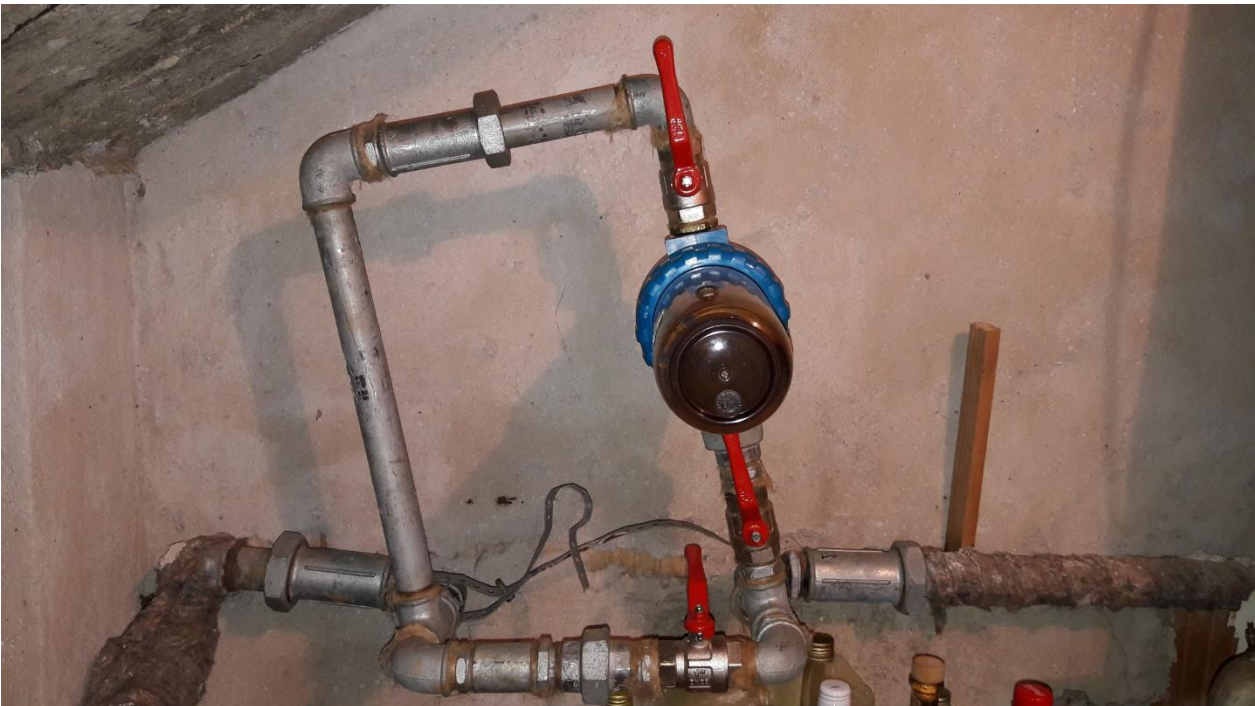
Slika 20: Cevi in filter z aktivnim ogljem pred vstop v hidrofor
