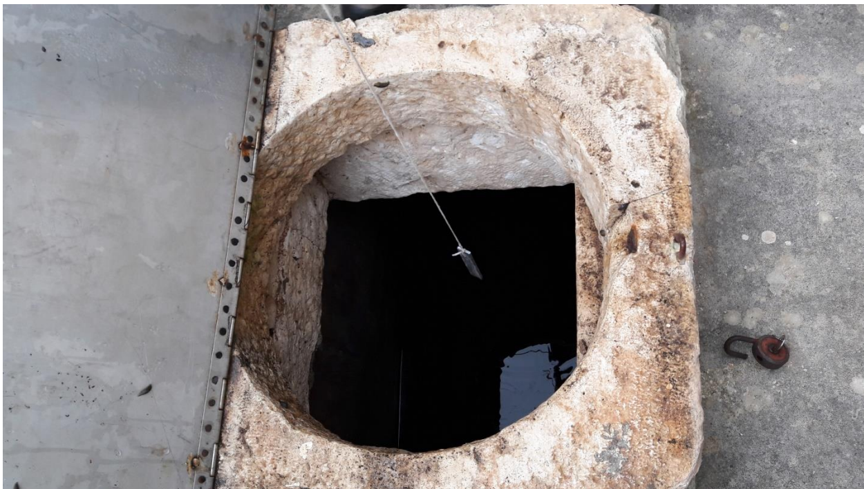
Slika 15: Merjenje količine vode v cisterni
