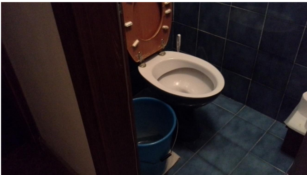
Slika 23: Vedro z odpadno vodo za splakovanje stranišča
