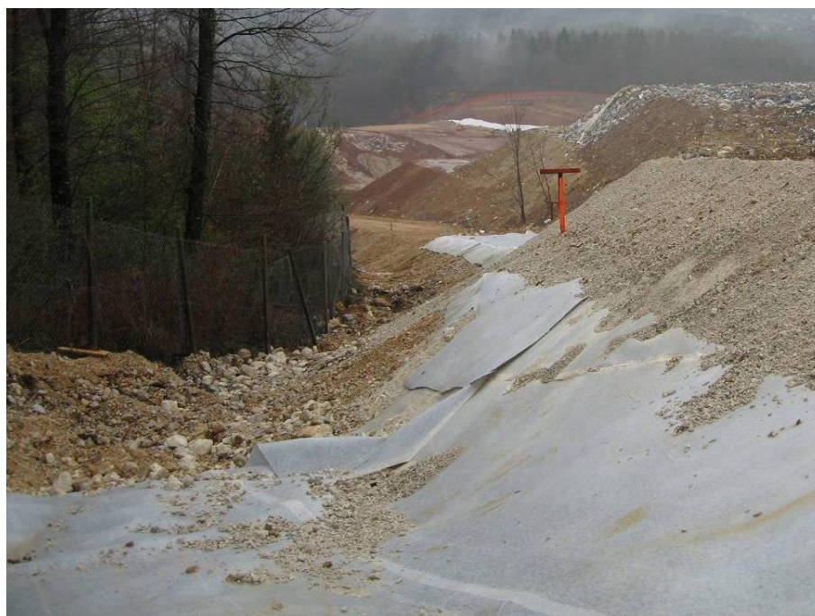
Slika 5.1: Tipičen primer nepravilne gradnje pokrova
