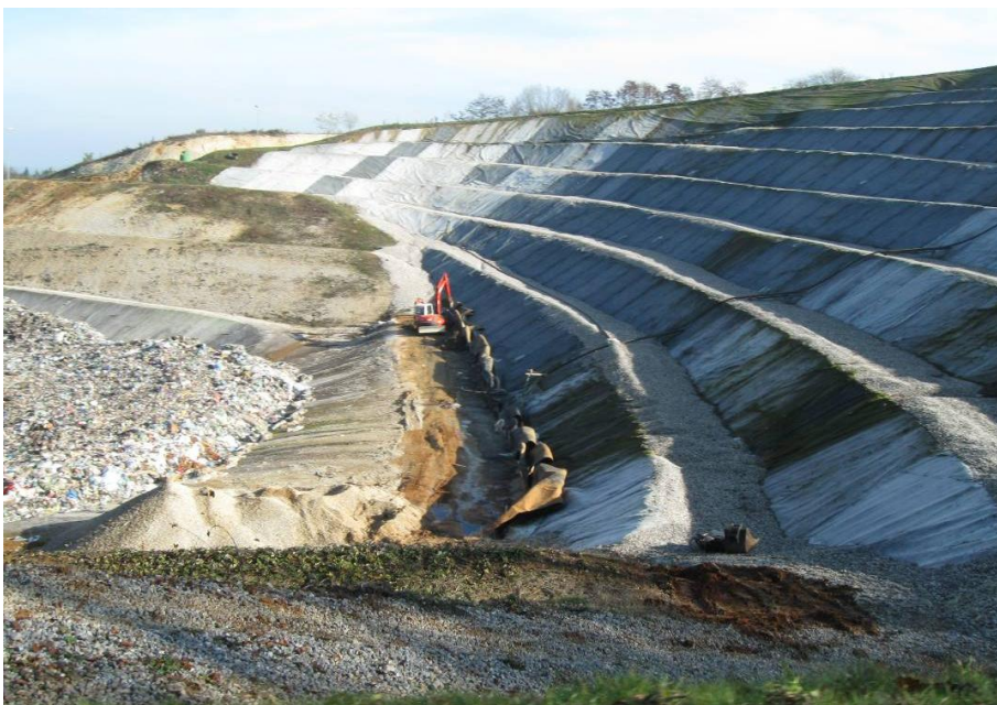
Slika 5.3: Odlagališče Leskovec. Sanacija berme zaradi nabiranja izcedne vode na bermi
