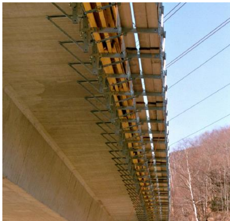
Slika 24: Pogled na opažni oder (vir Doka)
