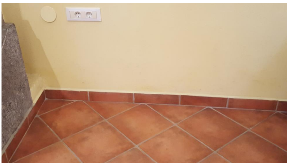
Slika 28: Na zidovih ni sledov vlage
