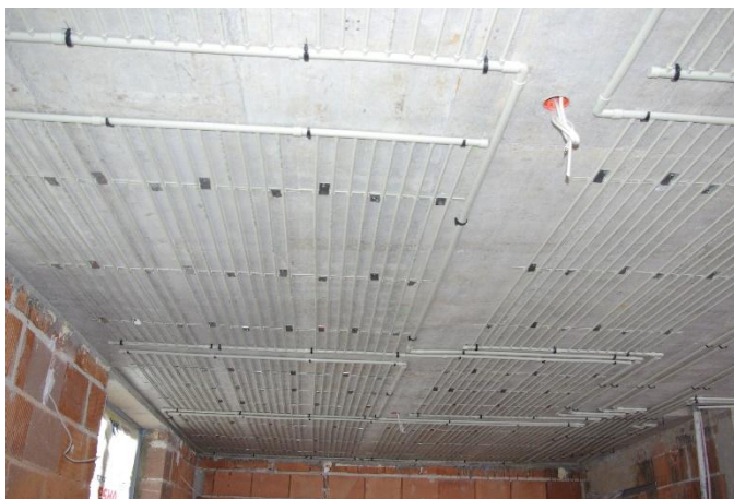
Slika 5: Razvod cevi za stropno pasivno hlajenje pritrjenih na AB ploščo Vir: Arhiv podjetja As Invest d.o.o
