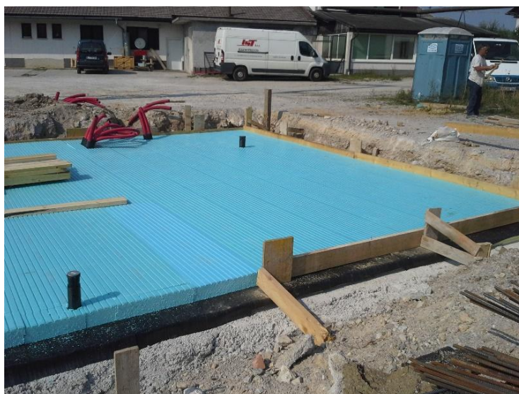
Slika 20: Polaganje 2 sloja toplotne izolacije v deb. 12cm (vgradnja nad hidroizolacijo) Vir: Arhiv podjetja As Invest d.o.o
