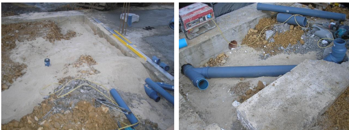
Slika 26: Razvod temeljne kanalizacije med AB pasovnimi temelji Vir: Arhiv podjetja As Invest d.o.o
