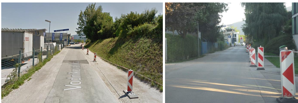
Slika 80: Stanje na vodnikovi ulici julija 2013 (levo), (Google Street View. 2016.) in stanje avgusta 2016 (desno)
