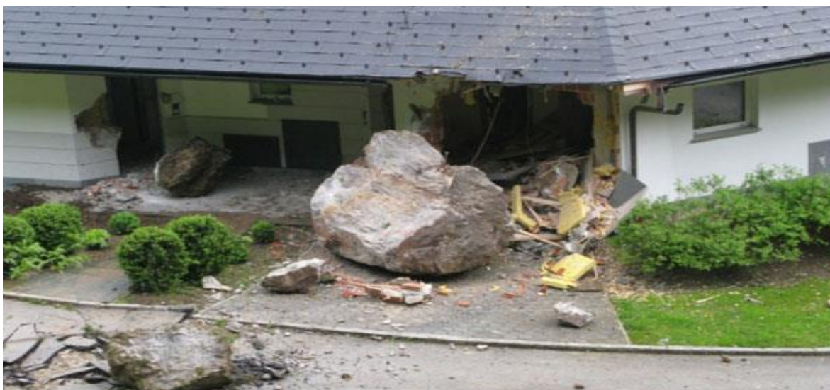
Slika 12: Močno poškodovana hiša zaradi skalnega podora (Savenc, 2012)
