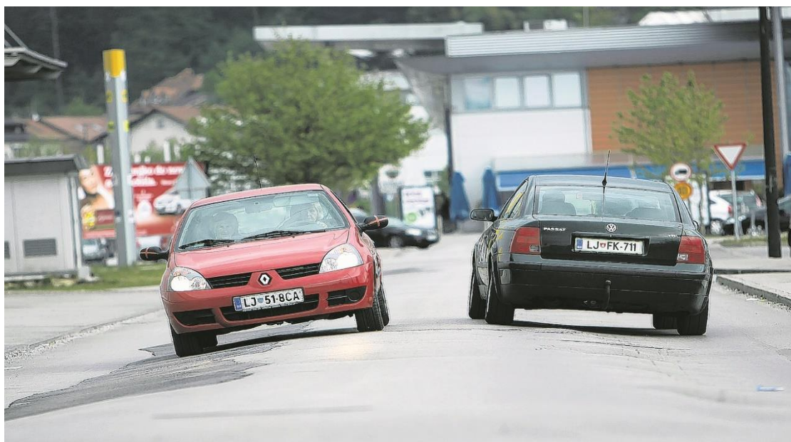
Slika 16: Poškodovano cestišče pri nakupovalnem središču na Rudniku (Porenta, 2011)
