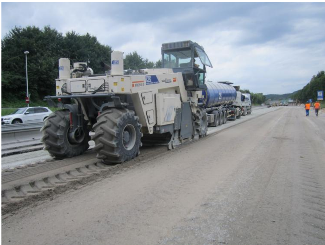
Slika 7 : Reciklažni vlak pri izvedbi bitumenske stabilizacije po postopku hladne reciklaže in situ na trasi HC (STRABAG, 2012)
