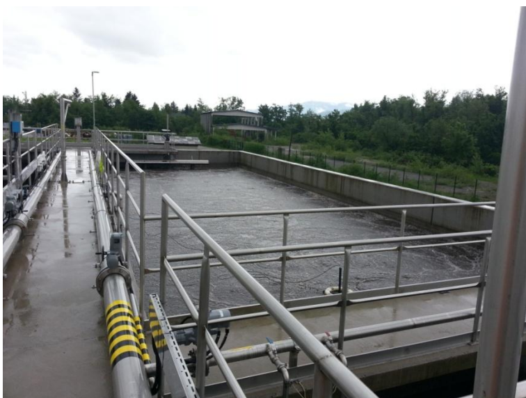
Slika 18: Bazen za čiščenje odpadne vode na ČN Vrhnika
