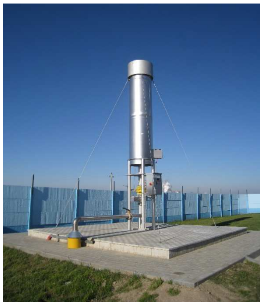
Slika 28: Bakla ČN Skidel (lasten vir)
