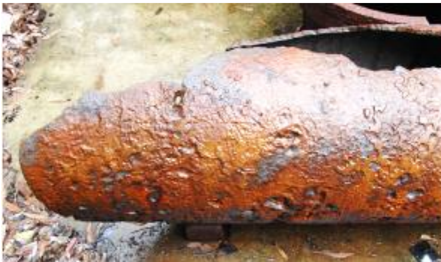
Slika 2: Korozija 110 let stare litoželezne cevi (Petersen, 2012)
