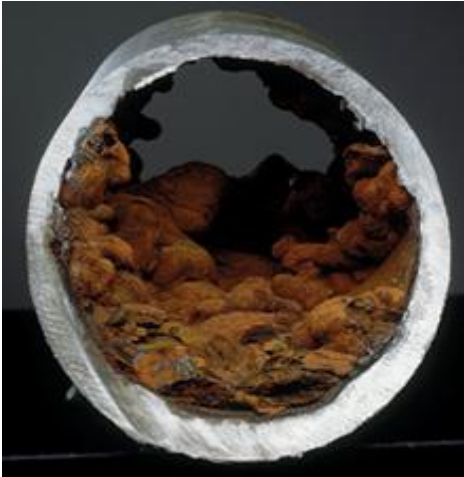
Slika 3: Notranja korozija in nalaganje mineralov znotraj pocinkane jeklene cevi (Delta Mechanical, 2016)
