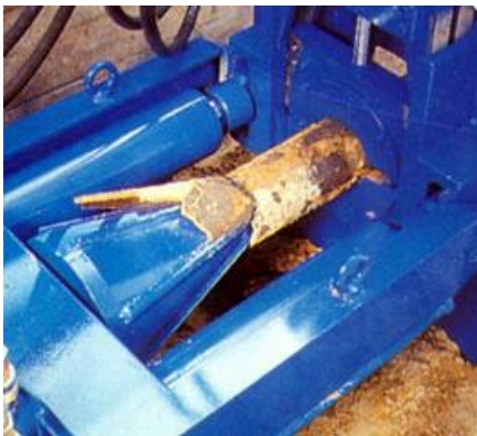
Slika 64: Razcepitev stare cevi (UNITECC, 2016)
