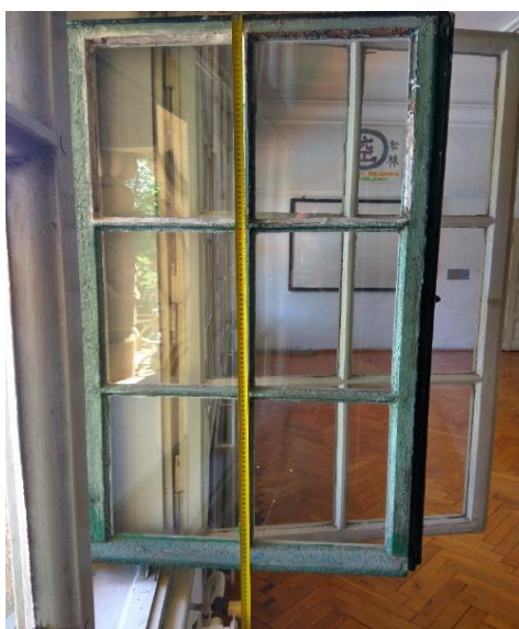
Slika 16: Merjenje in ocena poškodb dvojnega škatlastega okna v mali telovadnici (321)
