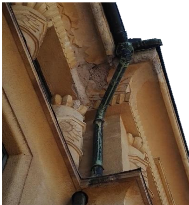
Slika 11: Poškodbe v območju kotlička - zahodna fasada
