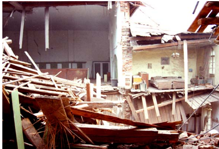
Slika 19. Porušitev dela objekta leta 1995
