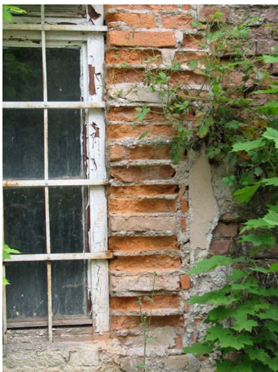
Slika 25: Izprana opeka na vzhodni fasadi
