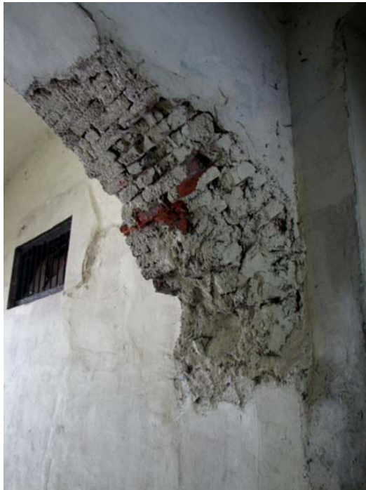
Slika 17: Načeto ležišče loka v odprtem prehodu v srednjem delu objekta
