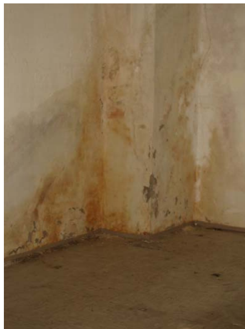
Slika 10. Poškodbe ometa zaradi kapilarnega dviga
