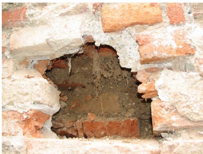
Slika 26: Razpadajoča opeka in malta v notranjosti, (pregledno mesto Z3)
