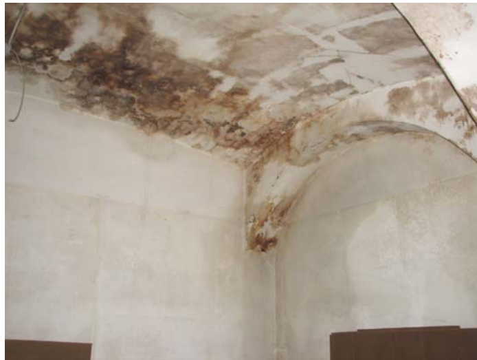
Slika 9: Poškodbe ometa (vlažen in plesniv) na oboku
