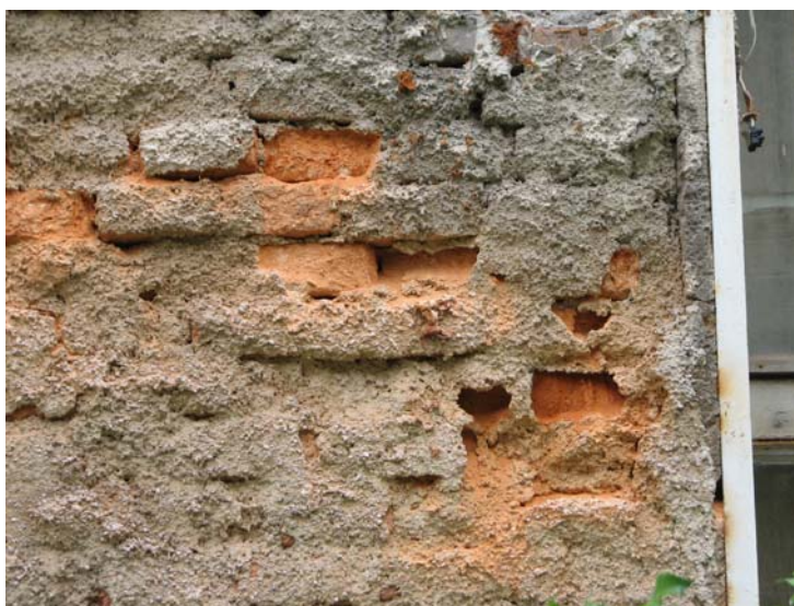
Slika 13. Razpadanje opečnih zidakov
