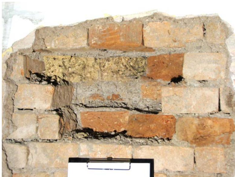
Slika 24: Nehomogena struktura opečnih zidakov, (pregledno mesto Z11)
