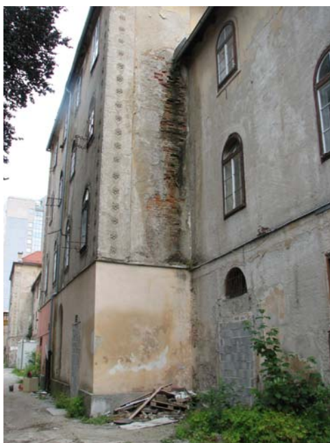
Slika 11. Spran zunanji omet ter opeka, poraščena z lišaji, zaradi neurejenega odvodnjavanja meteorne vode
