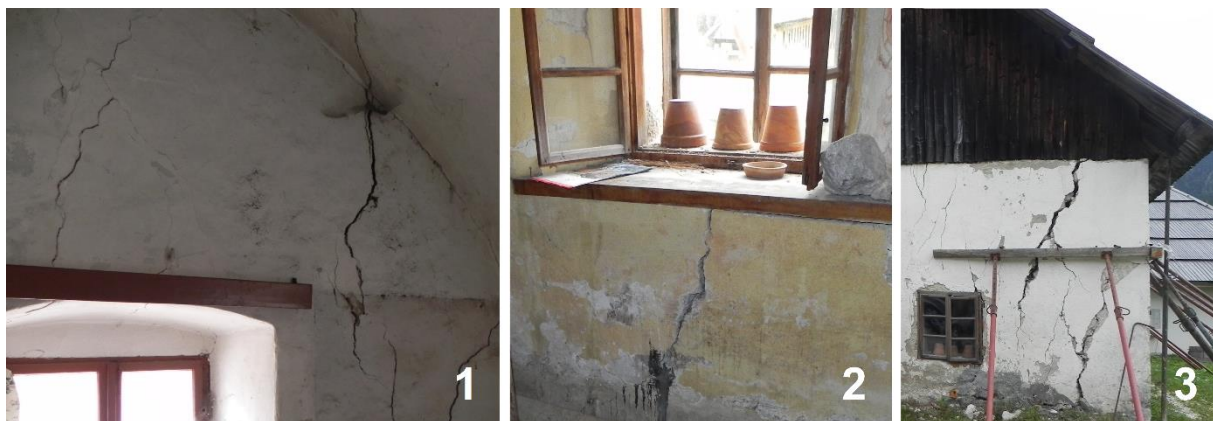
Slika 23: Razpoke na ometu severnega zidu (1 in 2) in konstrukcijske razpoke na severovzhodnem vogalu severnega zidu (3), ki potekajo po celotni širini zidovja v notranjost.
