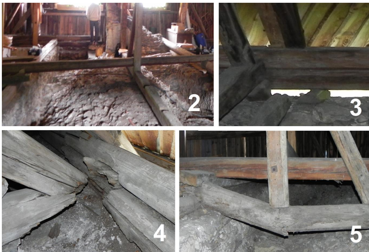
Slika 27: Kronološke deformacije in spremembe nosilne konstrukcije ostrešja.
