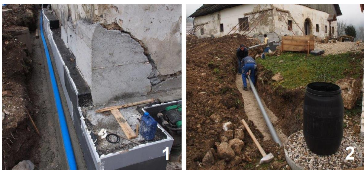
Slika 101: Drenažna cev vzdolž objekta speljana v odvodni jašek.
