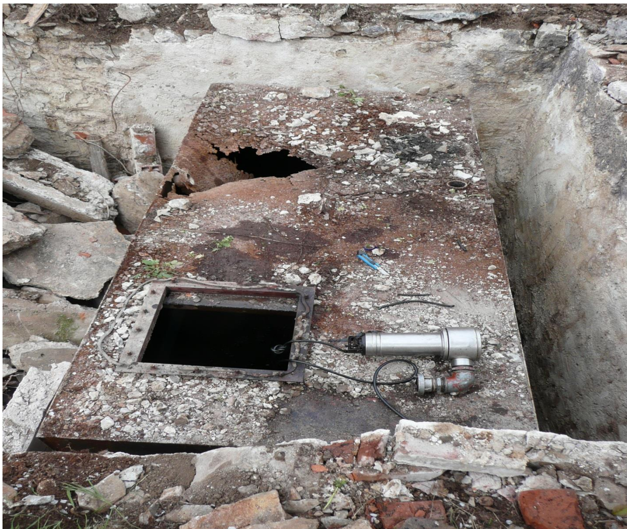
Slika 25: Podzemni rezervoar za gorivo
