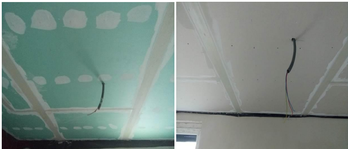
Slika 27 (levo): »Bandažiranje« vlago odpornih gips plošč visečega stropa Slika 28 (desno): »Bandažiranje« navadne gips plošče visečega stropa
