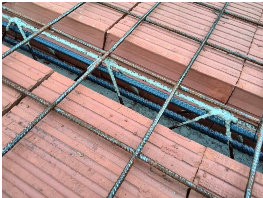
Slika 12: Ojačitev travet z dodatnimi armaturnimi palicami
