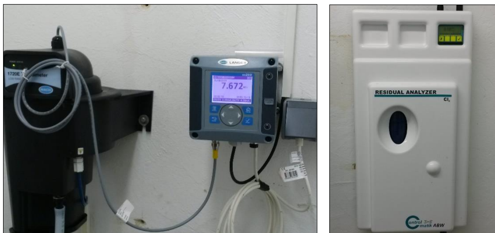
Slika 61: Elektronska oprema za dodajanje klora v cevi z vodo
