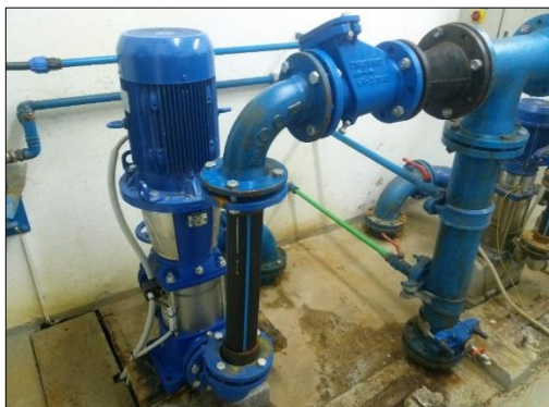
Slika 59: Črpalke v prečrpališču Jama
