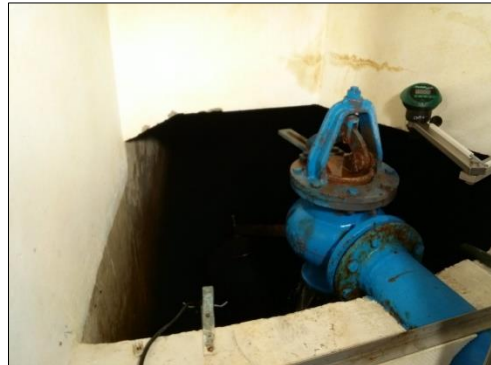
Slika 70: Vpogled v vodno celico
