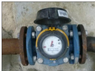
Slika 60: Merilnik pretoka na iztočni cevi črpalke prečrpališča Jama
