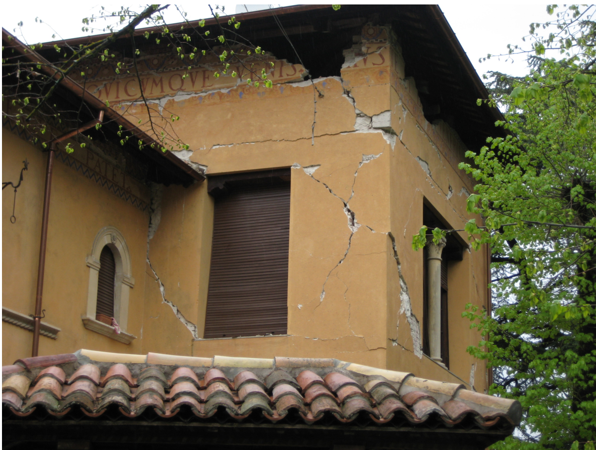
Slika 5: Prikaz poškodb na zidani stavbi po potresu v L'Aquili (Italija) leta 2009 (IKPIR, 2009)
