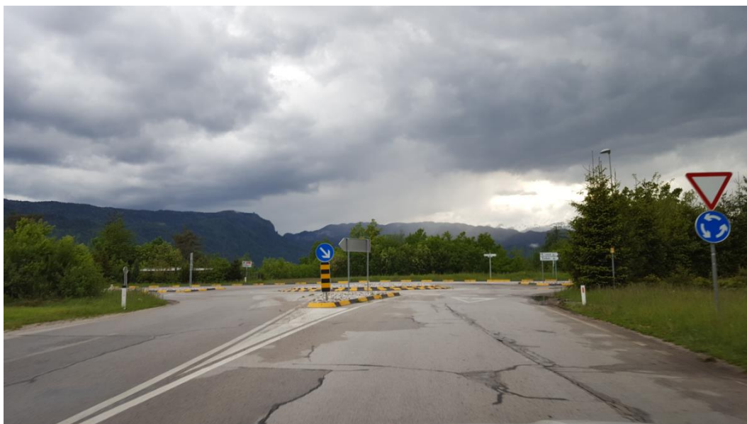
Slika 39: Pogled v križišče – iz smeri Lesce, Radovljica (v smeri naraščanja stacionaže), izvedeno stanje
