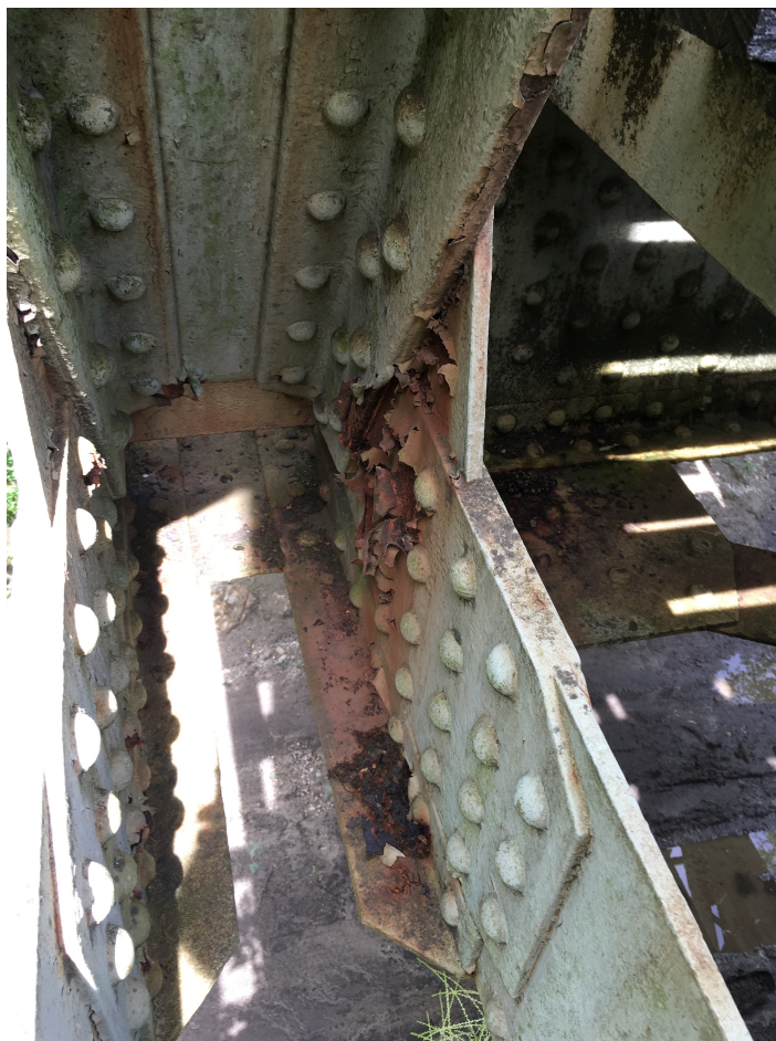
Slika 41: Stanje dotrajane mostne konstrukcije – detajl 3.
