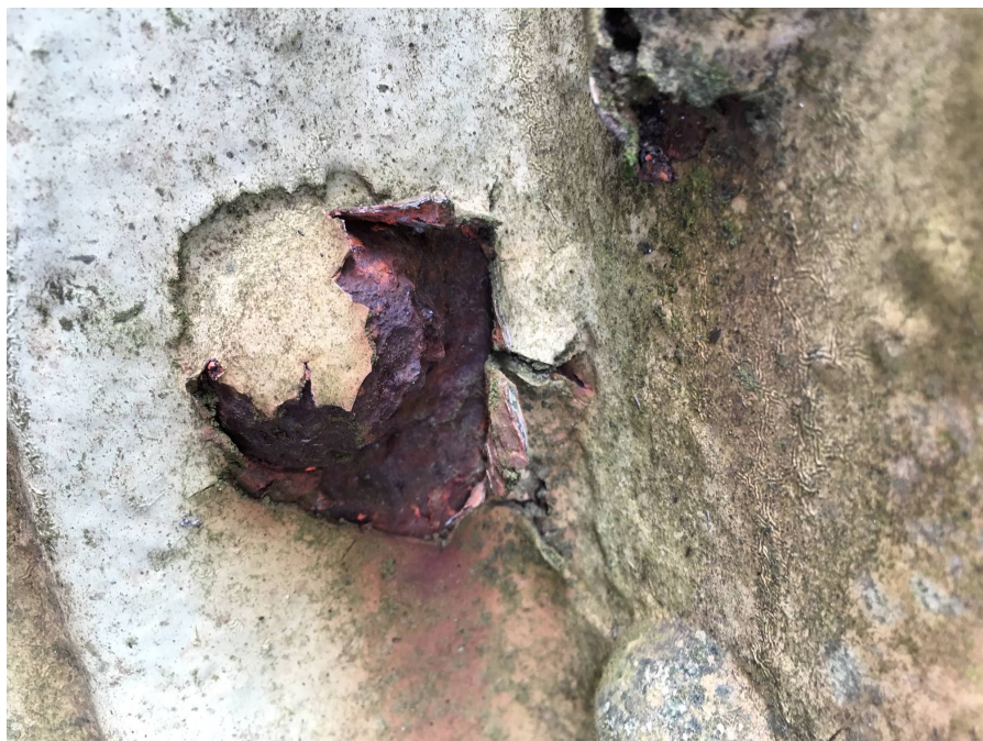
Slika 57: Razpad kovice na mostni konstrukciji.
