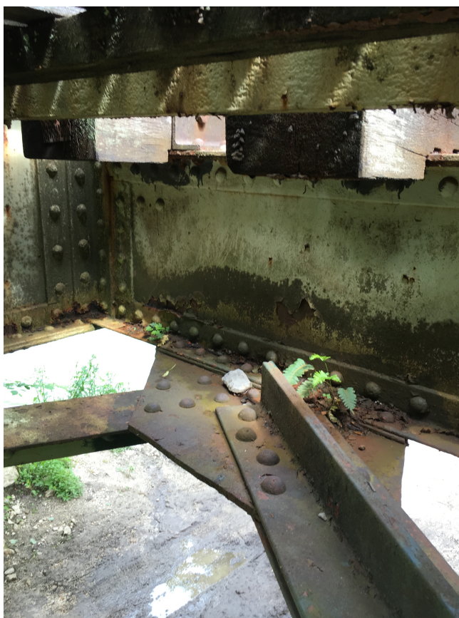
Slika 40: Stanje dotrajane mostne konstrukcije – detajl 2.
