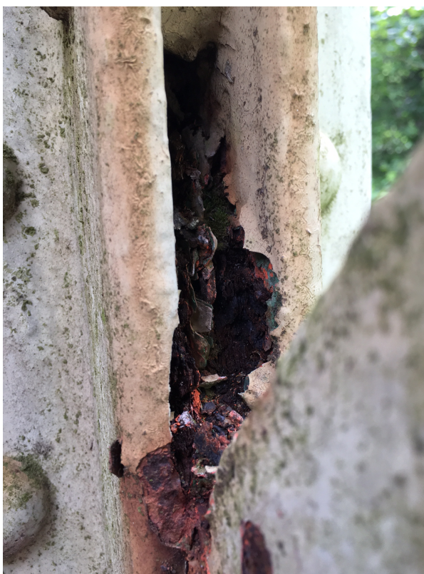
Slika 18: Zastajanje vode in umazanije, posledično sledi propad konstrukcije.
