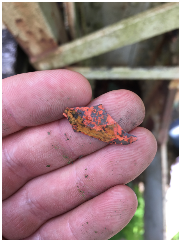
Slika 61: Vzorec propadle antikorozijske zaščite na mostni konstrukciji.
