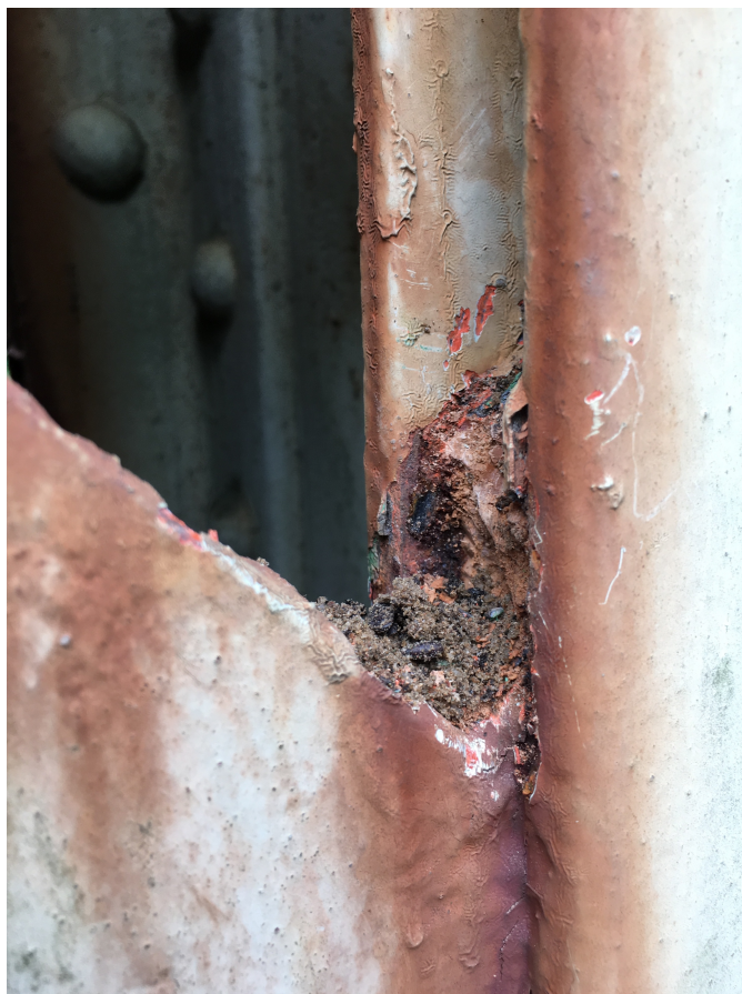
Slika 53: Konstrukcijski detajl dvojnih profilov, v katerih se zadržujeta voda in umazanija in ima za posledico nastanek špranjske korozije.
