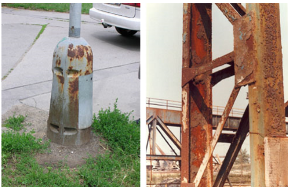
Slika 27: Splošna korozija (Skale, 2016).
