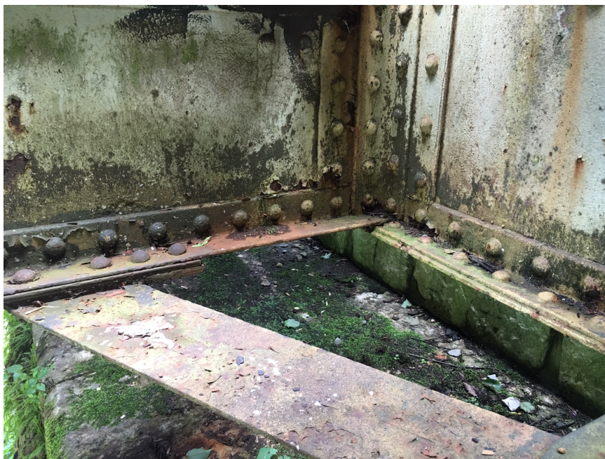
Slika 39: Stanje dotrajane mostne konstrukcije – detajl 1.
