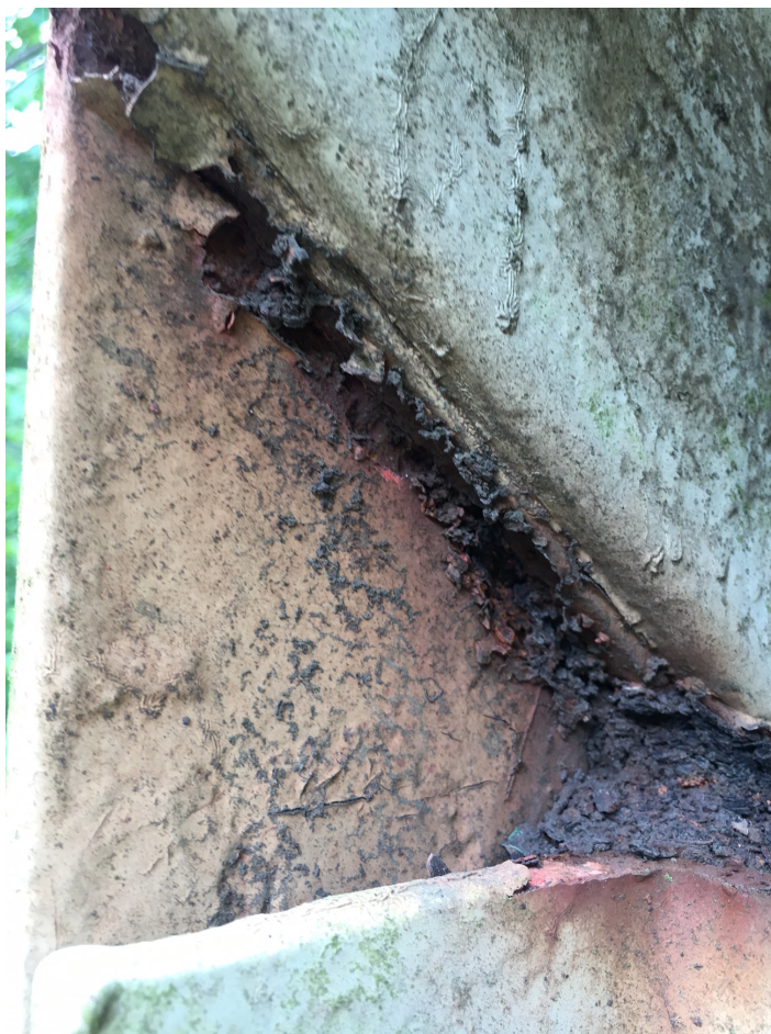
Slika 42: Pojav korozije v konstrukcijskem detajlu, zakrit z odpadlo barvo in umazanijo.
