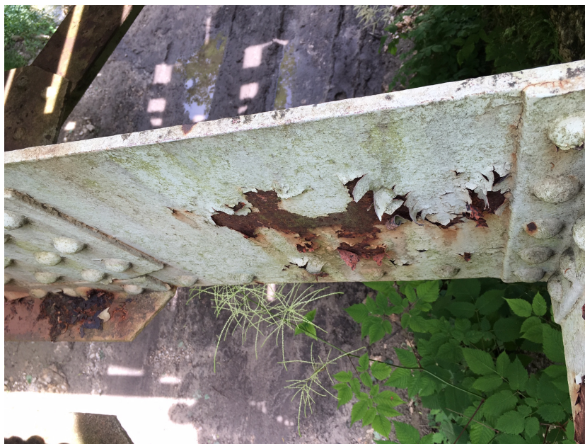
Slika 47: Korozija na ravni površini nosilca, v zavetni legi.
