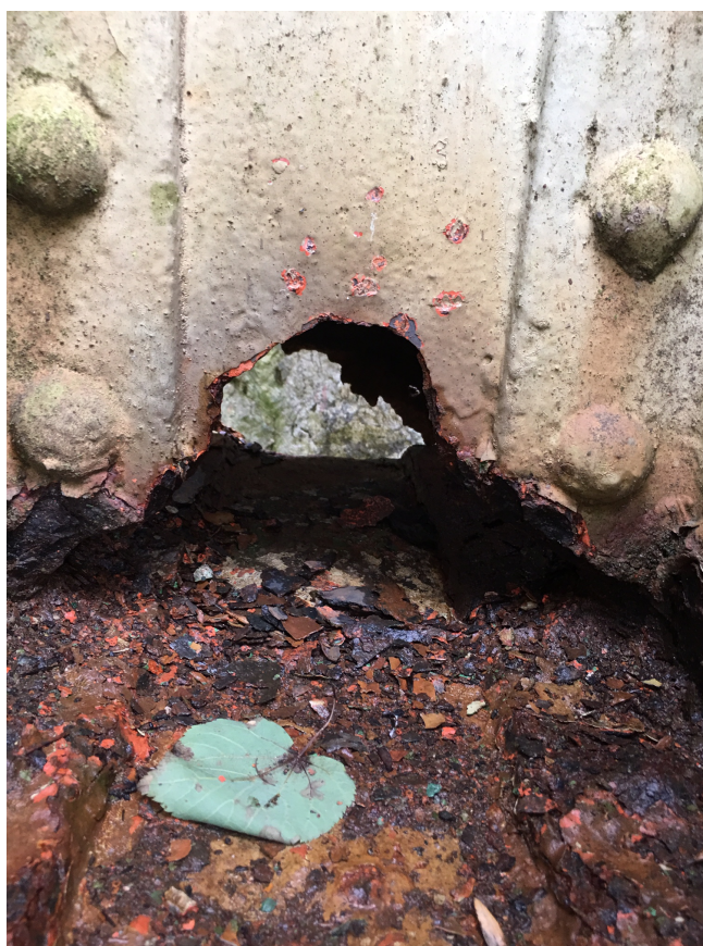
Slika 52: Propad konstrukcije v vozlišču.
