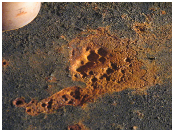
Slika 29: Pojav jamičaste korozije (Skale, 2016).
