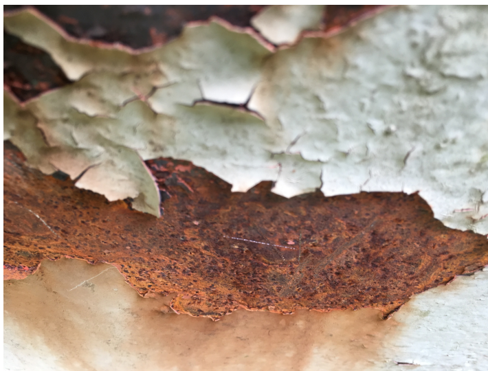
Slika 60: Luščenje barve z mostne konstrukcije.
