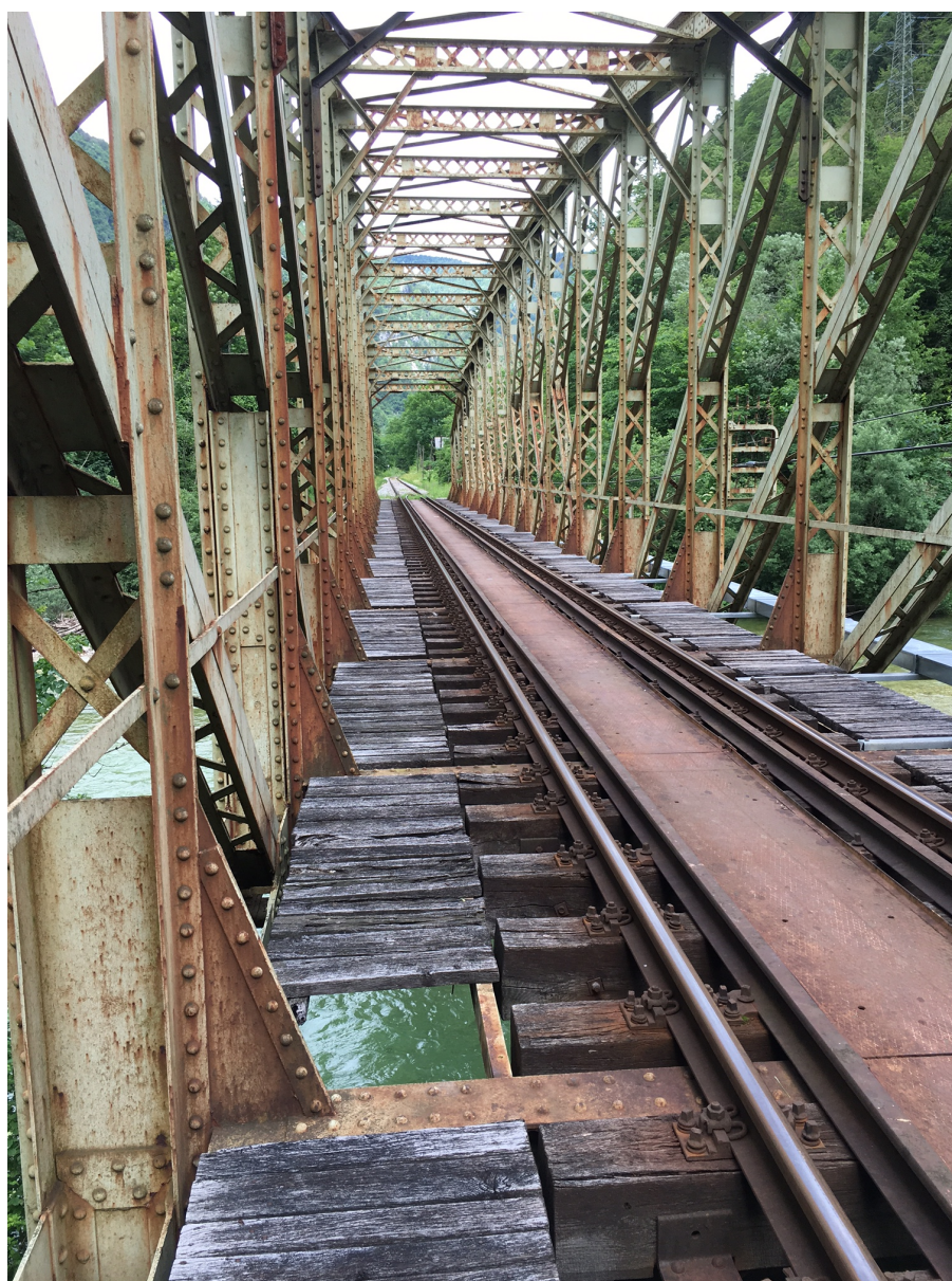
Slika 38: Stanje dotrajane mostne konstrukcije.
