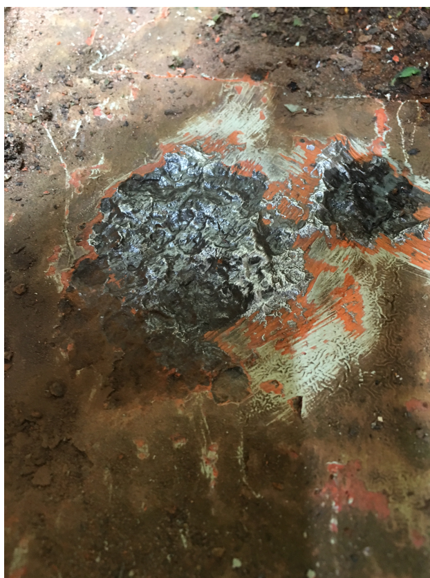
Slika 55: Pojav globinske korozije na nosilcih.
