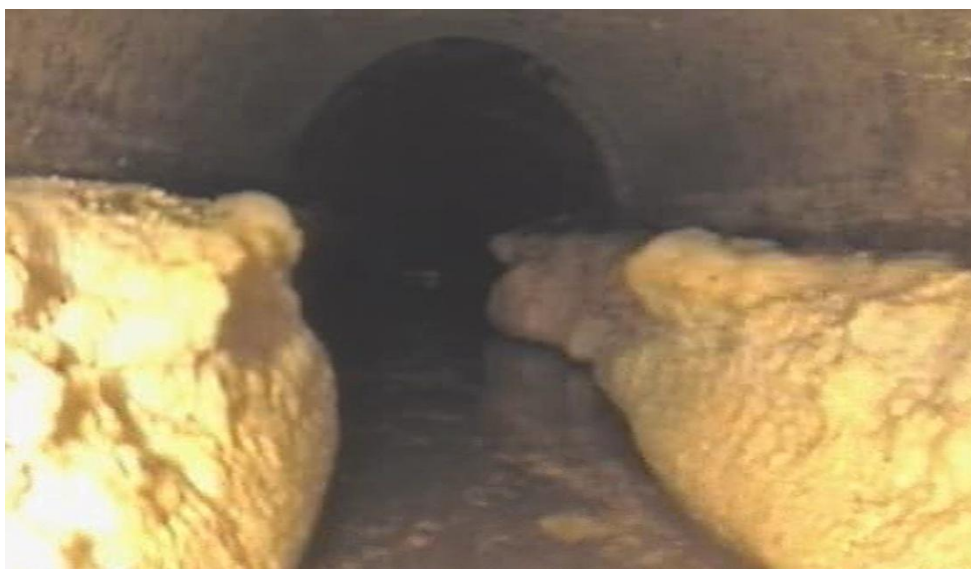
Slika 5: Maščoba v kanalizacijskem omrežju
