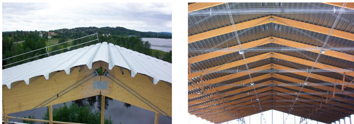
Slika 53: Levo, detajl izvedbe spoja v slemenu; desno, slika strešne konstrukcije z jeklenimi vezmi [38].
