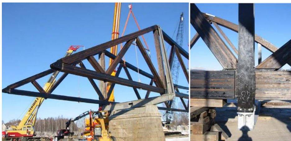
Slika 151: Primer zagotavljanja stabilnosti mostu: Levo – jeklen okvir U oblike na mestu podpore, desno – vertikalni jeklen steber v lesenem paličju [105].
