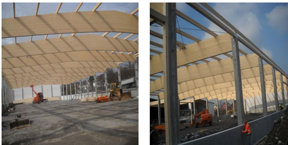
Slika 26: Primer uporabe sedlastega nosilca pri strešni konstrukciji hale v Ötisheimu v Nemčiji [26].
