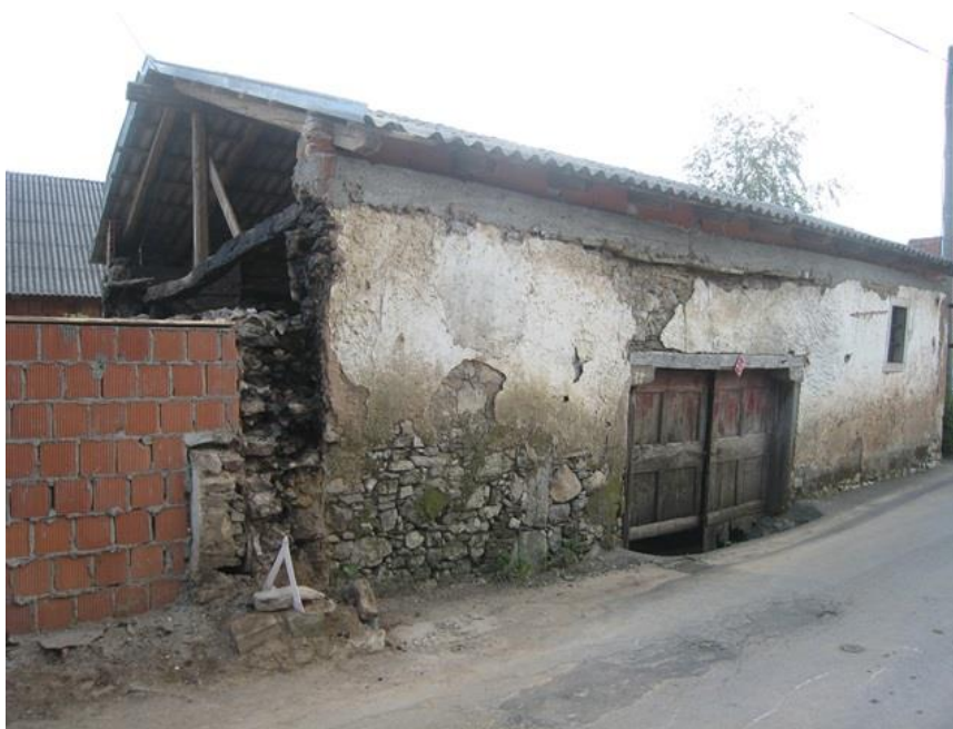
Slika 40: Problematika višine cestišča in dostopa v objekt
