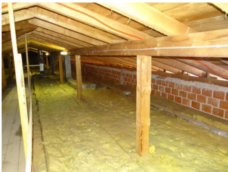
Slika 19: Neizoliran robni parapet na podstrešju (Vir: Lasten)
