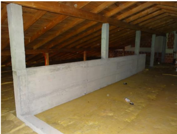
Slika 20: Neizolirani stebri in zid na podstrešju osnovne šole Heroja Janeza Hribarja (Vir: Lasten)
