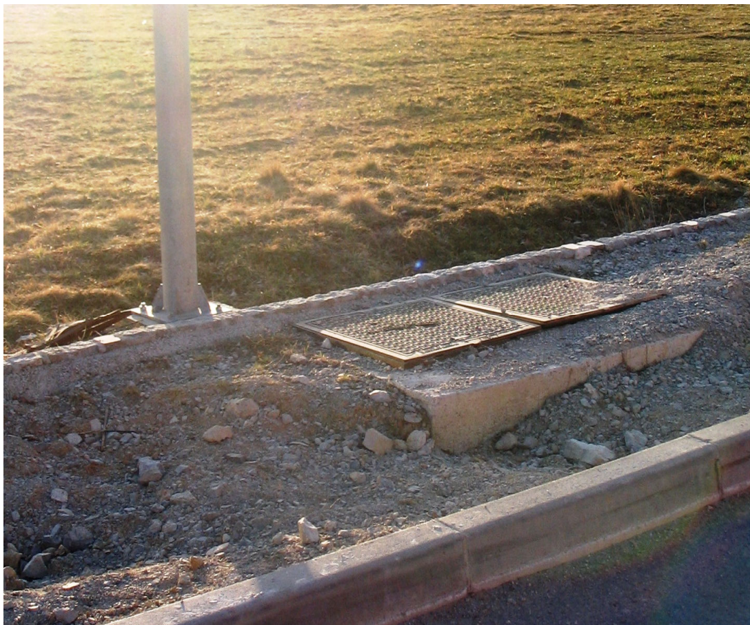
Slika 15: Elektro – kabelski jašek in podstavek za drog javne razsvetljave
