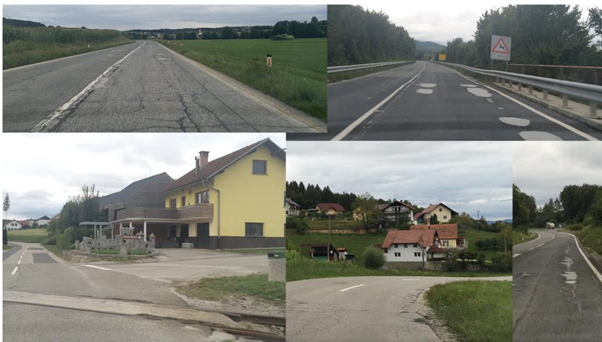
Slika 4: Primeri poškodb na vozišču
