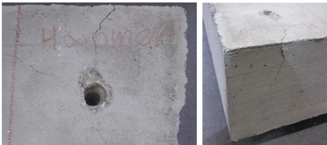
Slika 76: Razcep betona pri izvedbi izvlečnih preskusov v vogalu betona C20/25 (lasten vir, 2015)
