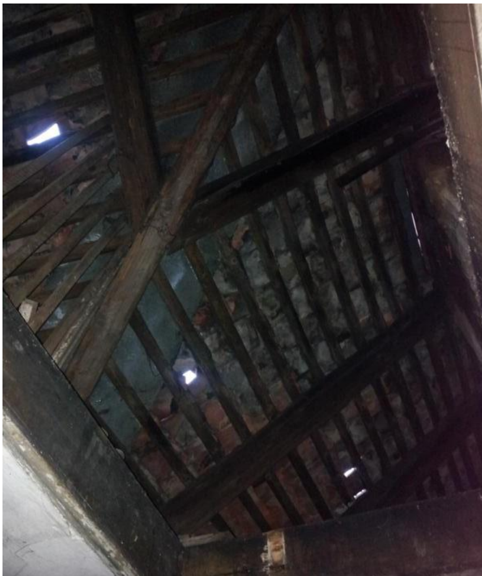
Slika 11: Poškodbe strehe in ostrešja. Vir: lasten
