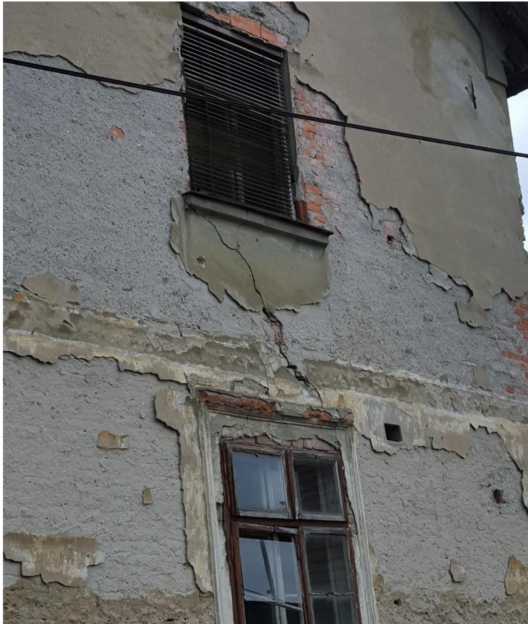
Slika 10: Razpoke v zidu. Vir: lasten
