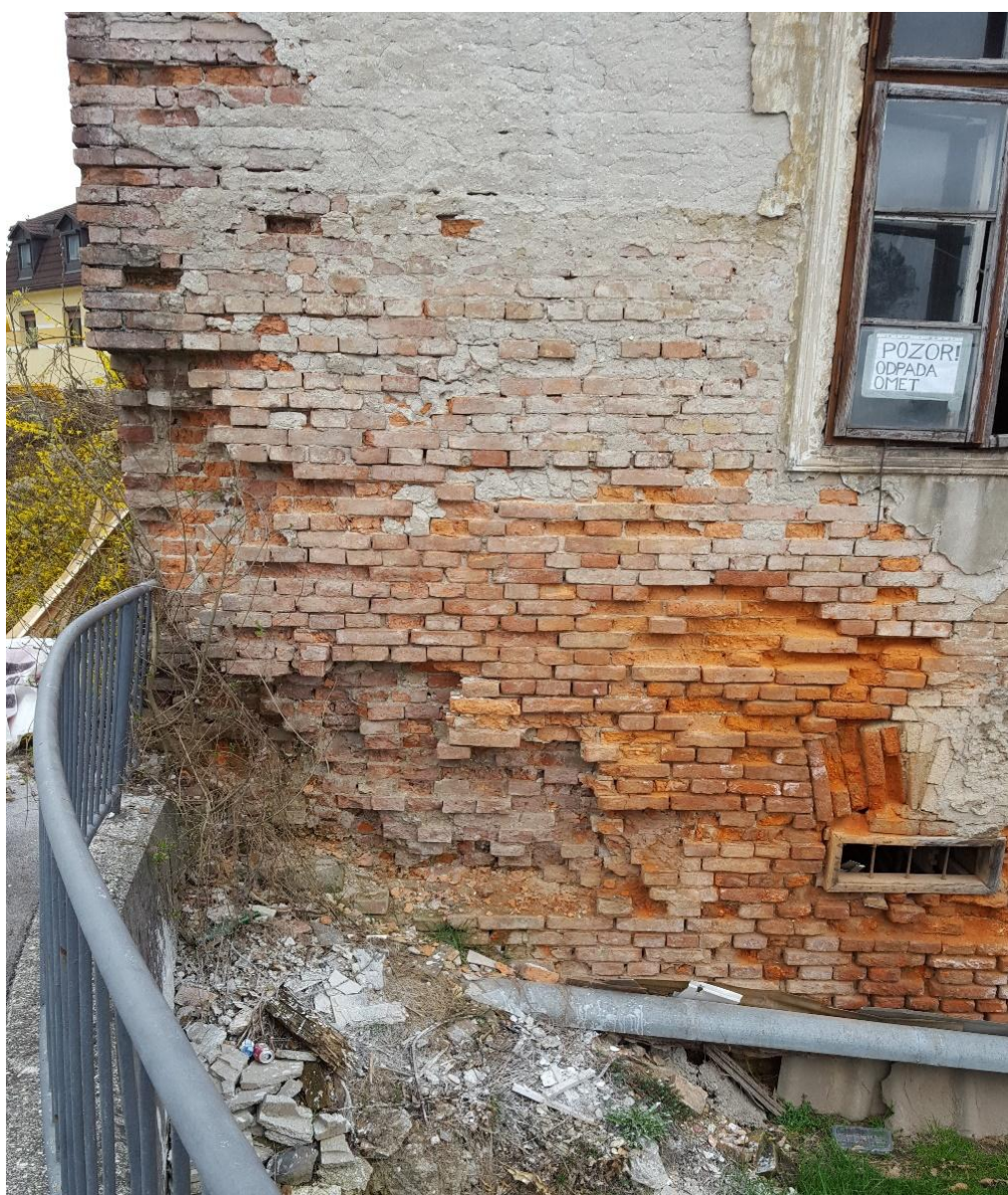
Slika 9: Poškodba jugozahodnega vogala. Vir: lasten
