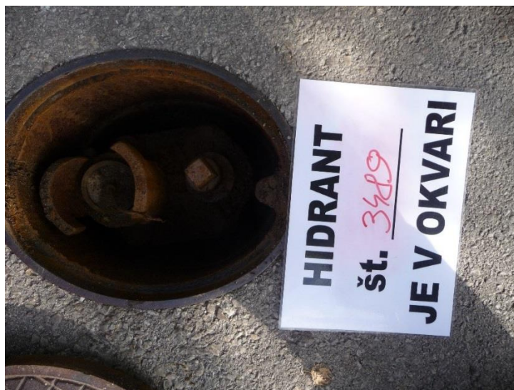
Slika 46: Poškodovano ustje hidranta (PGD Ljubljana Trnovo, 2014)
