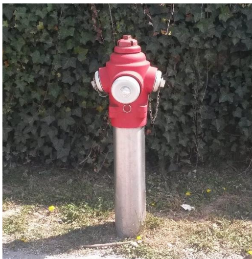
Slika 28: Nadtalni hidrant je viden na daleč in omogoča nemoten dostop do vira požarne vode, vidni so tudi priklopi za gasilske cevi (lasten vir, 2015)
