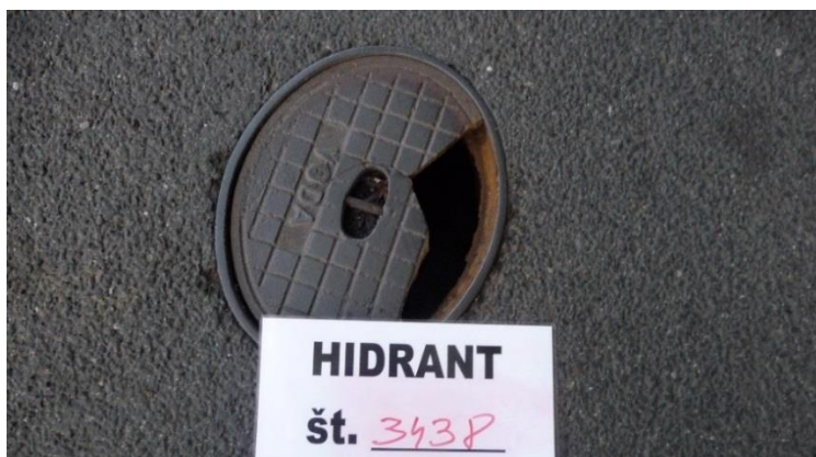
Slika 48: Poškodovana cestna kapa (PGD Ljubljana Trnovo, 2014)
