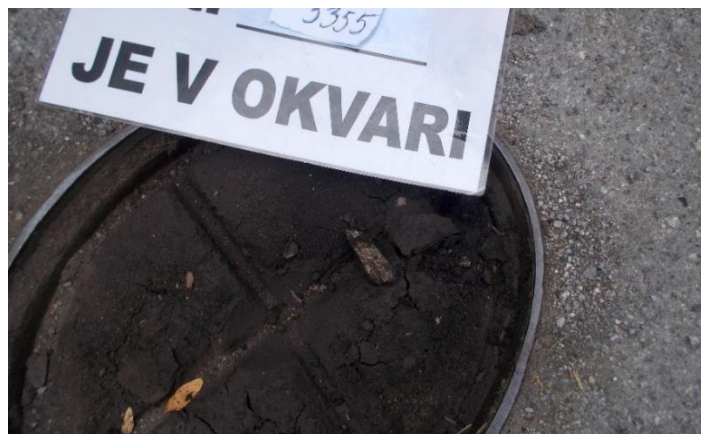
Slika 47: Zablaten podzemni hidrant (PGD Ljubljana Trnovo, 2014)
