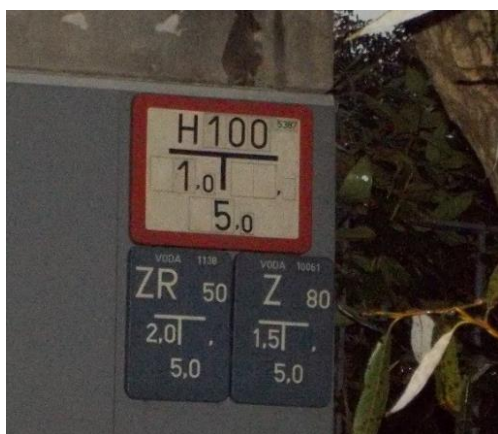
Slika 25: Hidrantna tablica, ki nakazuje lokacijo hidranta (PGD Ljubljana Trnovo, 2014)
