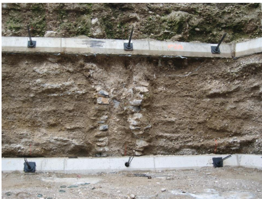
Slika 41: Neustrezno sidro z oznako Ss20 in sidro Sz20 zaklinjeno na 100 kN. (Vir: lastna fotografija)
