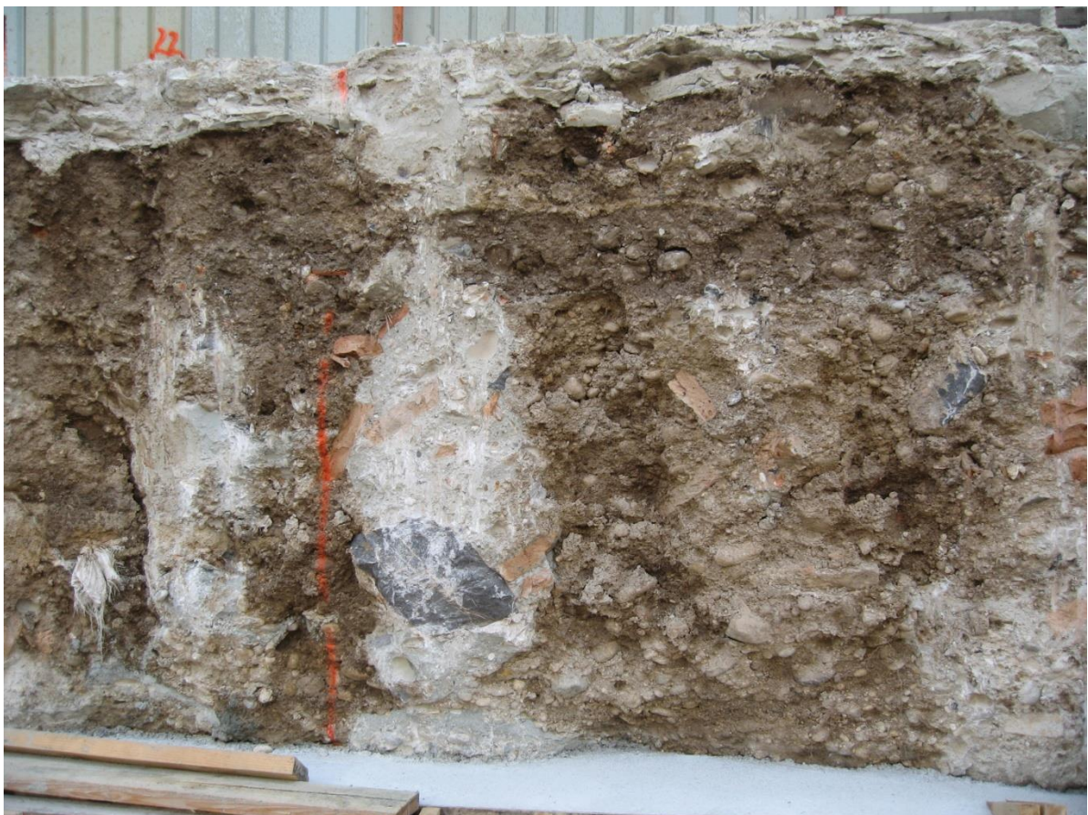
Slika 26: Pogled na os F po odkopu, kjer se lepo vidi zmanjšani prerez slopov v zgornjem metru ob vročevodu. (Vir: lastna fotografija)
