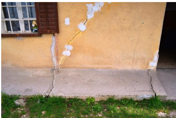
Slika 29: Razpoke na objektu Šmihel 51 (Foto: Miha Lamovec)
