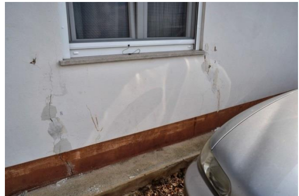
Slika 26: Razpoki pod oknom na objektu Šmihel 50a (Foto: Miha Lamovec)
