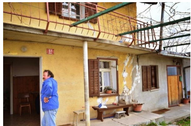
Slika 28: Razpoke na objektu Šmihel 51 (Foto: Miha Lamovec)
