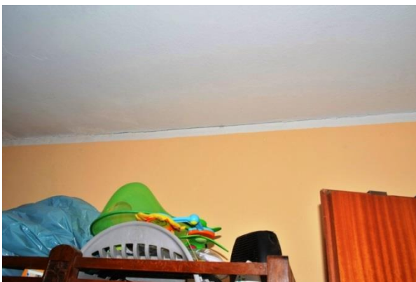
Slika 27: Razpoka med steno in stropom v objektu 50a (Foto: Miha Lamovec)
