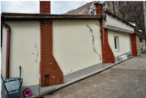
Slika 25: Razpoke na objektu Šmihel 50a (Foto: Miha Lamovec)
