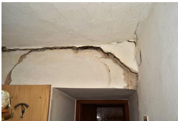
Slika 30: Razpoke v notranjosti objekta Šmihel 51 (Foto: Miha Lamovec)
