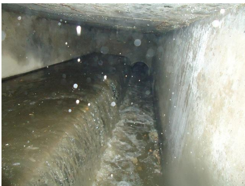
Slika 23: Razbremenilni objekt pri prelivu (slikano 21. 11. 2015, ob 9:00 uri, ob največjem prelivu)
