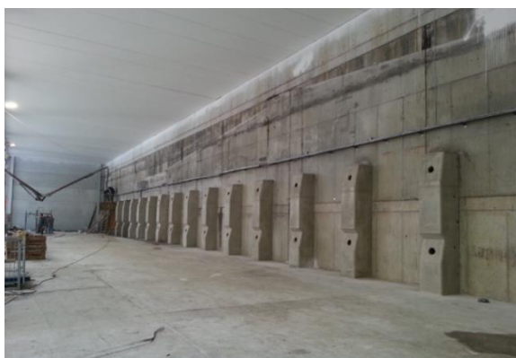
Slika 23: Stanje zidu (z zgrajenimi oporami) med ničelno in drugo terminsko izmero.
