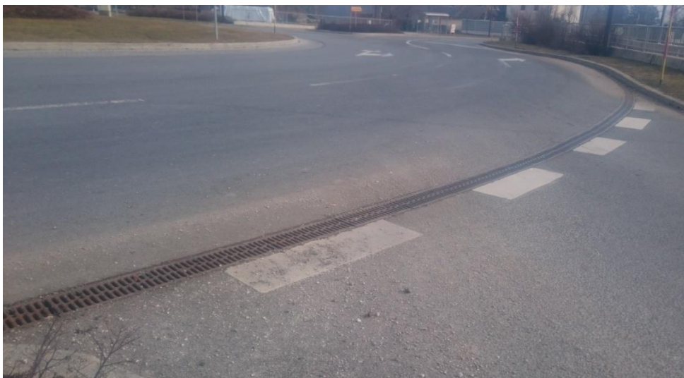
Slika 18: Linijski požiralnik v krožnem križišču (foto: Žagar, 2016)
