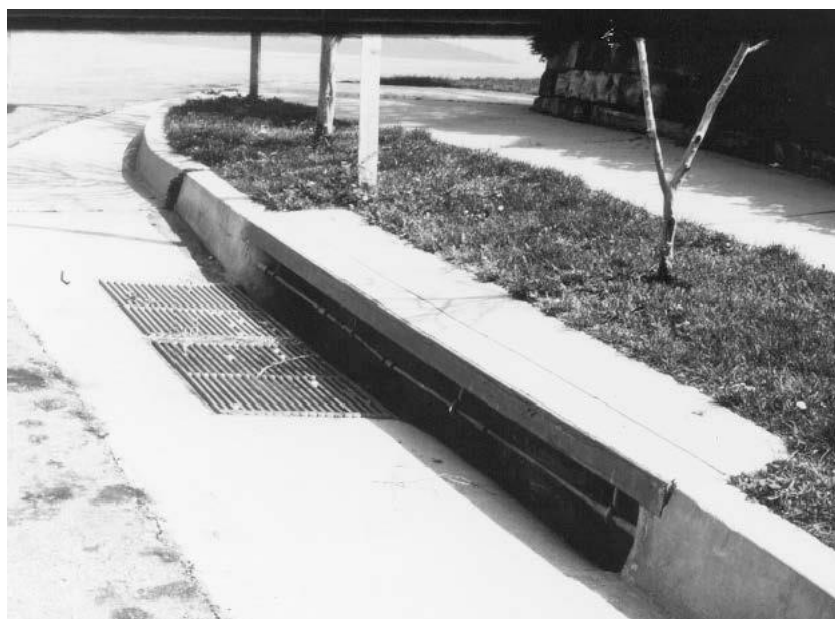
Slika 16: Kombiniran požiralnik iz vtočne odprtine v robniku ter vzporednih rešetk pod robnikom (Brown in sod., 2013)
