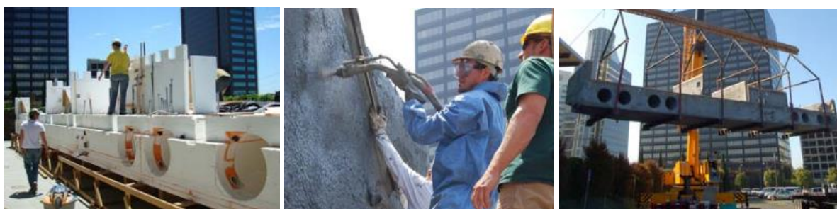
Slike 16: Potek gradnje plovnega temelja za amfibijsko hišo FLOAT House: EPS jedro z inštalacijami; brizganje betona ojačanega s steklenimi vlakni (GFRC); končni izdelek plovnega temelja (Float House, 2009a: str. 2, 3)
