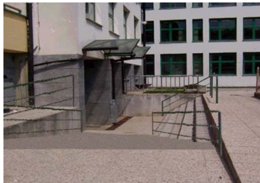
Slika 30: Ureditev dostopa do južnega vhoda v osnovno šolo: zamenjava dela stopnišča s klančino, podaljšanje stopnišča na desni po celotni liniji, postavitve varovalnih ograj in prestavitve koša za smeti na ustreznejšo lokacijo.
