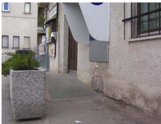
Slika 35: Neustrezno izvedena klančina pod bankomatom ob trgovini z gradbenim materialom v Gasilski ulici – za vozičkarje je otežena uporaba tako bankomata kot klančine.
