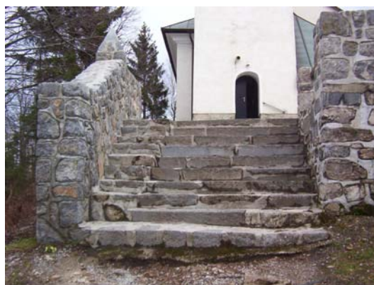
Slika 68: Stopnišče ob koncu križevega pota predstavlja nepremagljivo oviro za vozičkarje, zato je zanje potrebno zagotoviti dostop do cerkve po novi poti, speljani mimo stopnišča. Prav tako na stopnišču manjkajo ročaji za ljudi, ki se težje gibljejo.
