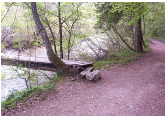
Slika 77: Nevaren začetek zasilnega mostu čez reko Iško.
