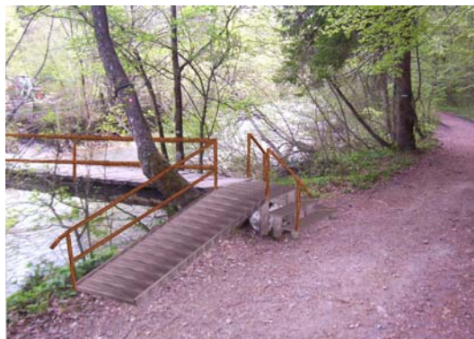
Slika 78: Ureditev začetka mostu s klančino in stopnicami. Obnoviti je potrebno celoten most.
